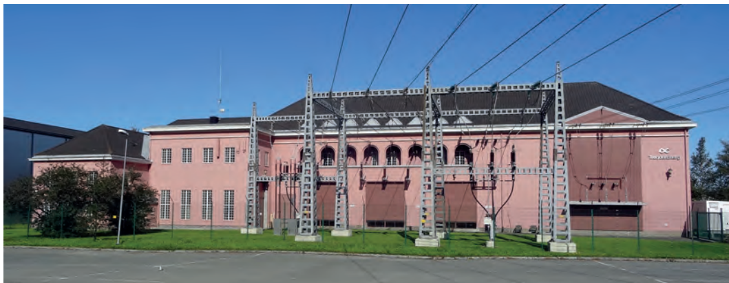
Sørsiden av Moholt transformatorstasjon i september 2018. Fra venstre: Fløy for 6,6 kV anlegget, fløy for verksted og kontrollrom og hovedfløy for transformatorene. Foto: Knut L. Vik.
